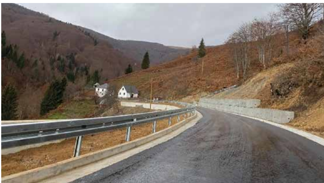
Klizište - Gnjlji potok - Nadzor na sanaciji klizišta „Gnjila Potok“ na putu Mateševo-Andrijeвица od klizišta dužine 140 m u okviru kojeg je izvršena rekonstrukcija kolovozne konstrukcije
